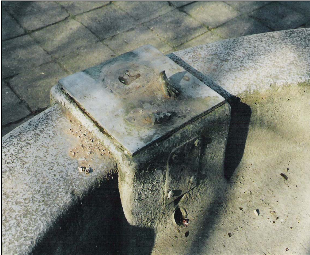
Bild 11; Die Beschädigung erfolgte am 04.02.02
