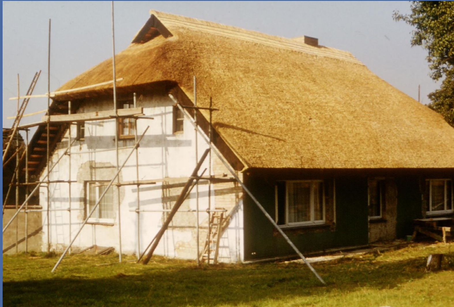
Ein neues Rohrdach ist gelb, es dunkelt, da das Rohr an der Oberschicht verwittert.
