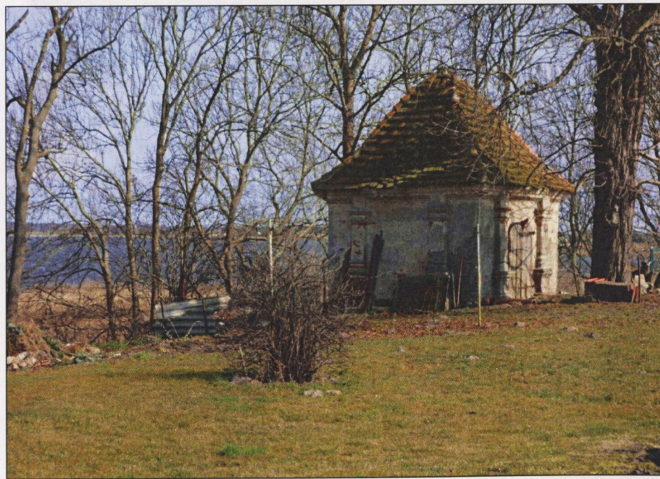
Das Mausoleum von Ostklüne im Jahr 2014. Im Inneren des Gebäudes befinden sich 14 Särge. Das Bauwerk ist derzeit dem Verfall ausgesetzt.
